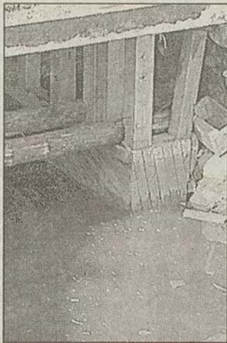
мельницу, а накануне второй мировой на реке Оредеж возвели систему плотин с небольшими гидроэлектростанциями для нужд окрестных поселков. В 60-х годах микроэлектростанции ликвидировались по всей стране, и на Оредеже остались никому не нужные сооружения. Год назад в правительстве Ленинградской области рассматривался проект возрождения малых электростанций — но пока этот проект есть только на бумаге.
