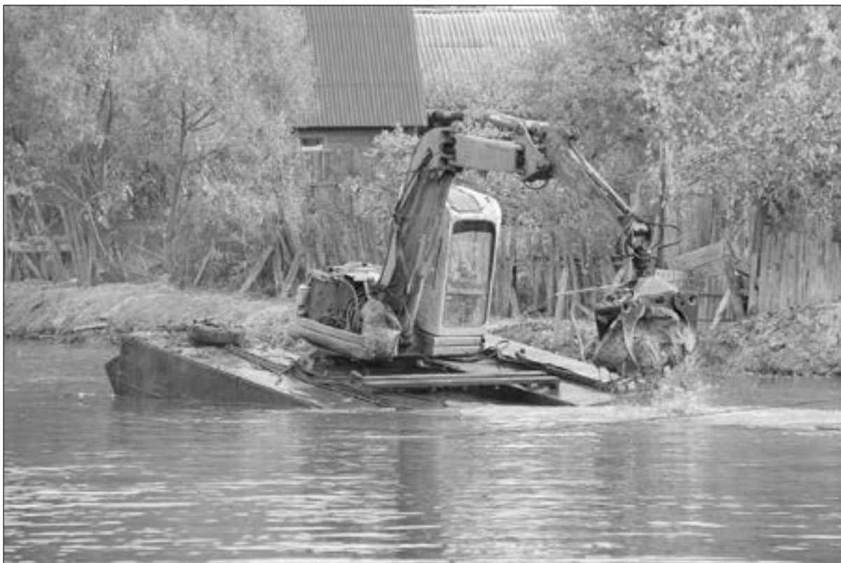
В сентябре 2021 года ООО «НПО «ЭкоГидроТехнология» приступило к расчистке русла Ижоры от железнодорожного моста до отметки 300 метров выше автомобильного моста в п. Мыза-Ивановка.
