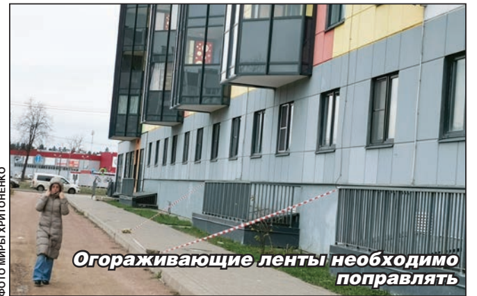
Обрушившаяся рама ударила по стенке лоджии, разбив стекло, которым с внешней стороны обшиты лоджии в этом доме
